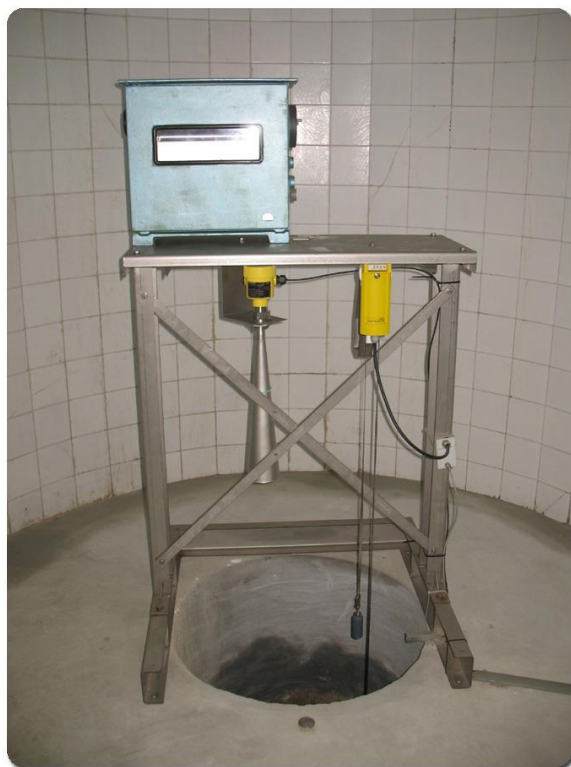
Registrador mecánico, codificador digital y sensor radar
